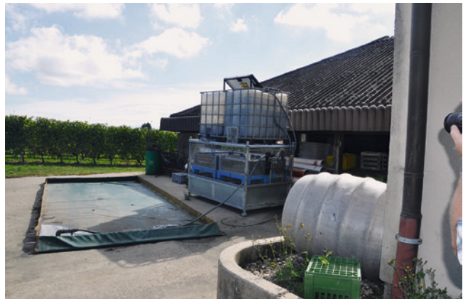
Mobiler Reinigungsplatz: Das Reinigungswasser wird bei Verwendung fortlaufend in den Rückhaltetank abgepumpt. Aufgrund fehlender Überdachung muss die Blache nach der Benutzung abgebaut werden, um ein Überlaufen bei möglichen Regenereignissen zu verhindern, M. Hochstrasser.
